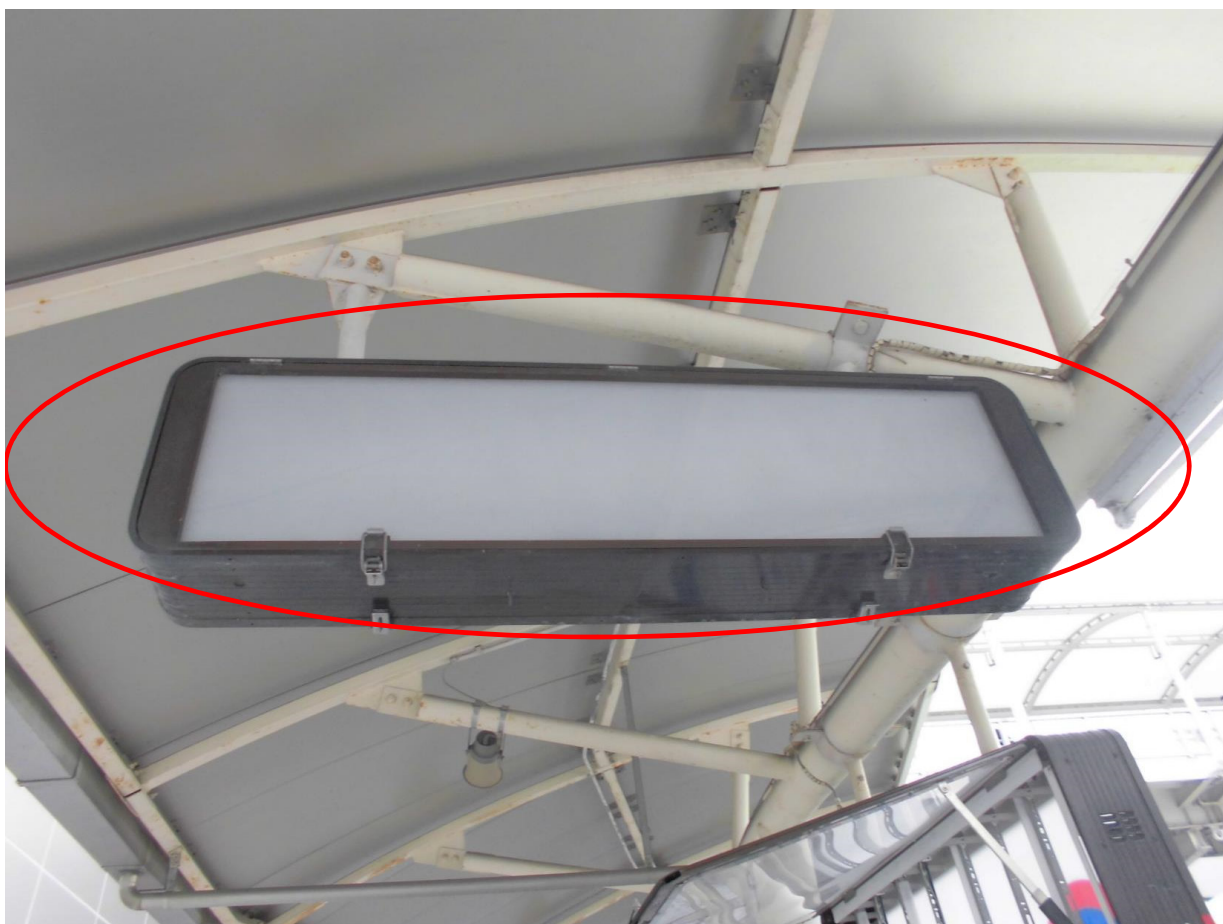
吊下げ6箇所 (FLR40W/M/36 40形 36ワット フロリッドランプ)
